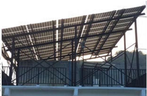
▲ รูป 2.1-4 แผงโซลาร์เซลล์ติดตั้งบนหลังคาโรงแรม
